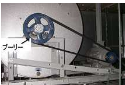
Vベルトの設置状況
