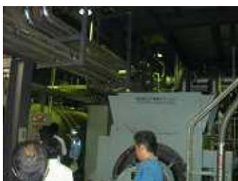
バイオマス発電設備(森ヶ崎水再生センター)
