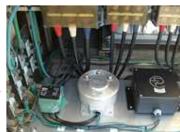
キュービクル高圧受電設備にEPフィルターを設置して効果を検証
